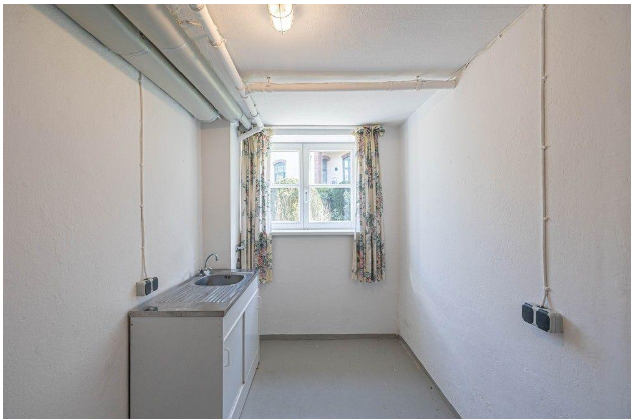
Hier befinden sich Küchenanschlüsse
