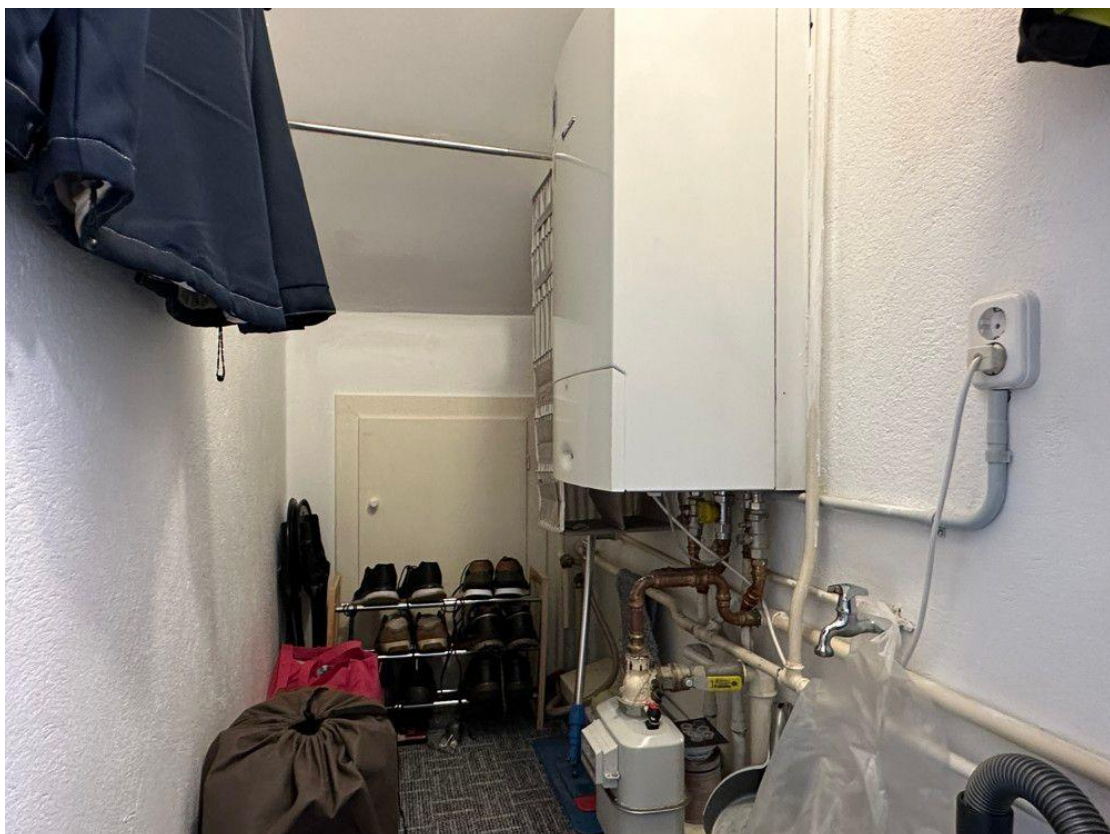
Abstellraum mit Gasetagenheizung
